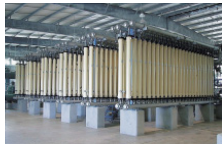
「マイクロザ™」を使用した水処理施設
