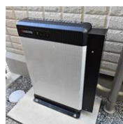
共用で設置された蓄電池
