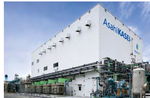
2024年度 川崎製造所においてアルカリ水電解パイロット試験設備が本格稼働
