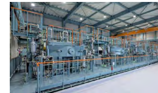
当社川崎製造所の水素製造用アルカリ水電解パイロット試験設備
