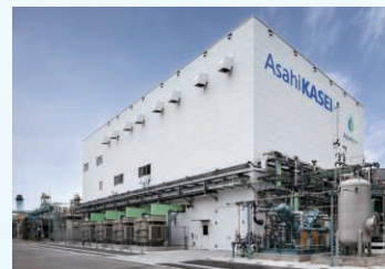
水電解パイロット試験設備外観 (当社川崎製造所)
