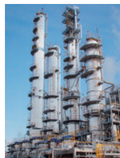
東西石油化学のAN製造プラント
